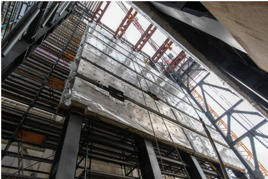
Figure 6: The HRSG closing plates
