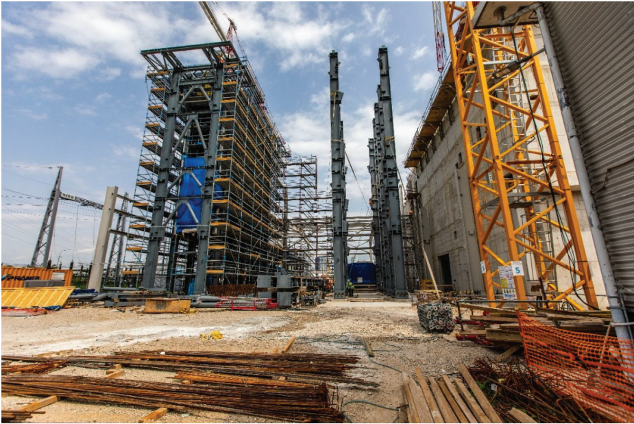
Figure 5: The HRSG casing steel structure
