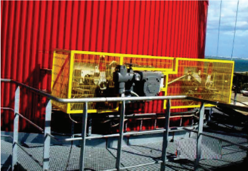
Figure 10: The HRSG water dumper drive
